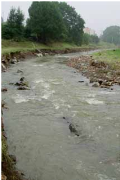
Poškozená levobřežní berma - v popředí jsou patrné zbytky patky
