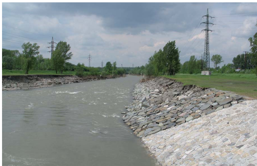
Ostravice, jez Hrabová - poškozené břehové opevnění pod jezem
