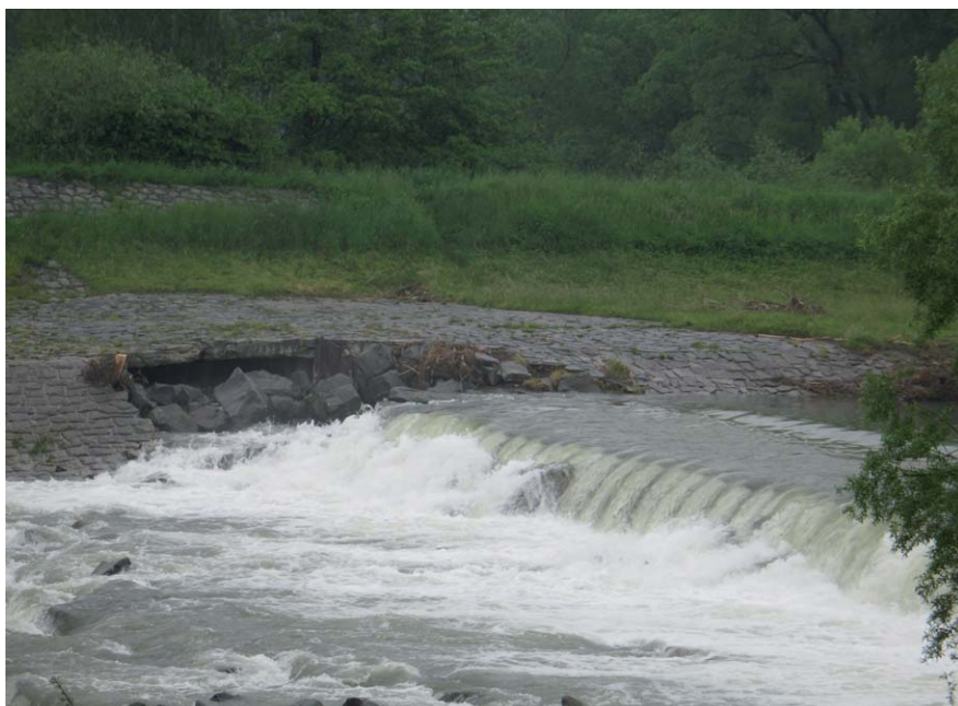
Olše, Karviná - poškození zavázání larsenového stupně
