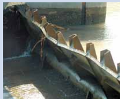
Jez Vítkovice – deformace levé jezové klapky po povodni 2010
