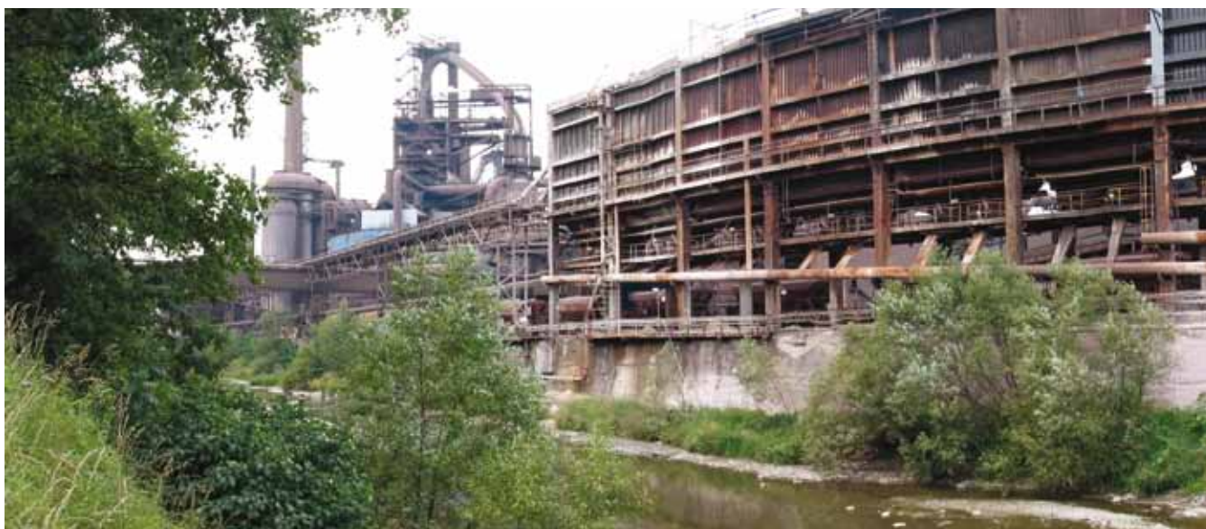
Pravobřežní opěrné zdi podél řeky jsou přímo součástí průmyslového areálu železáren (km 47,4 – po toku)
