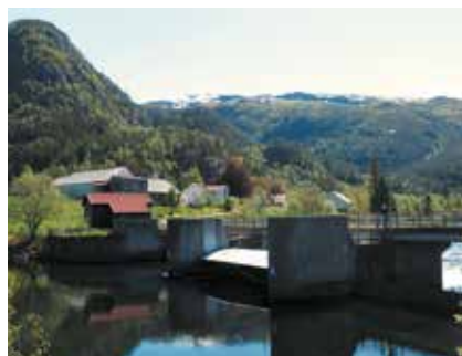
Zakrytí jezového pole pro snížení hlučnosti
