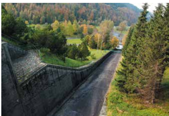
Původní stav skluzu
