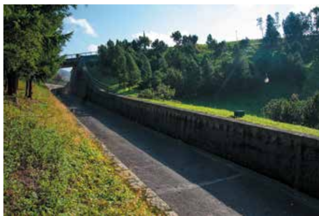
Původní stav skluzu
