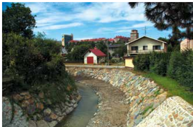
Porubka – úprava přes Porubu na 20letou vodu je opatřena jednostrannou pojízdnou bermou pro umožnění strojní údržby
