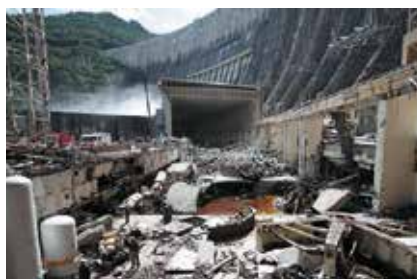
Obr. 4: Elektrárna po katastrofě
