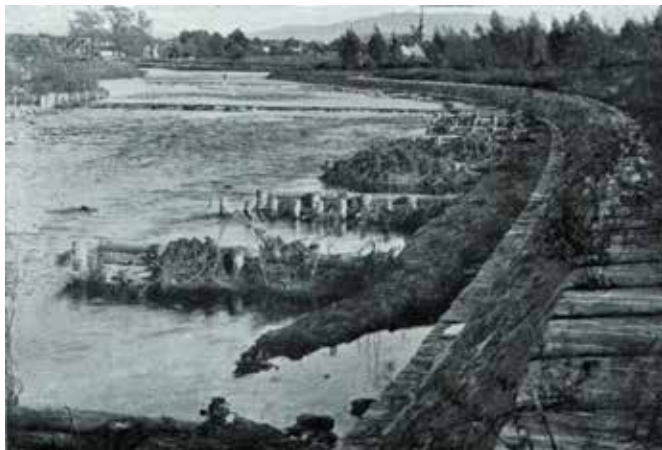
Stav výhonů poškozených povodní v roce 1915 na levém břehu Ostravice pod ústím Morávky
