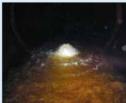
Průsak v blízkosti napojení ocelové konstrukce na betonovou konstrukci štoly
