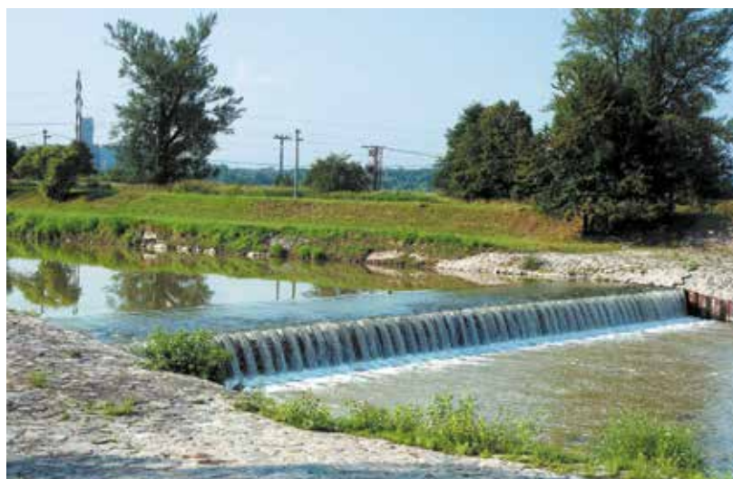
Larzenovův spádový stupeň na Olši vybudovaný v souvislosti s přeložkou toku v polovině šedesátých let
