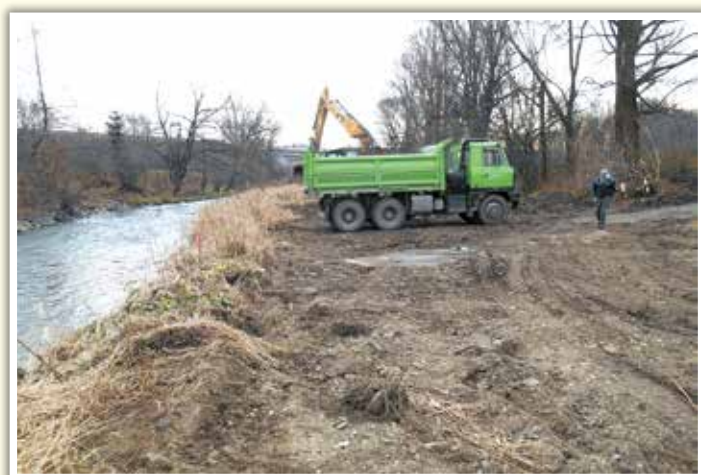
Lavice č. 1 – nános zabírá přes polovinu šířky koryta
